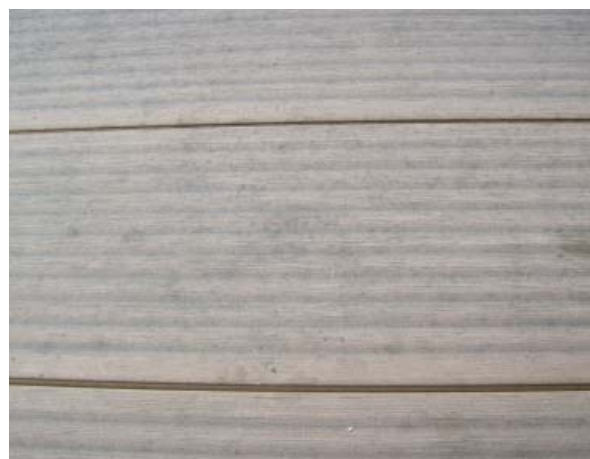
Stav povrchu dlouhodobě neudržované terasy.
